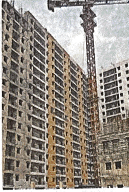
जेलरवाला बाग, अशोक विहार में पूरा होने को है डीडीए के ईडब्ल्यूएस फ्लैटों का निर्माण कार्य • सौजन्य : डीडीए
